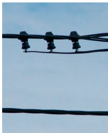
Main line 1 set of ASA every 500 m Hauptfreileitung Satz der ASA je 500 m
