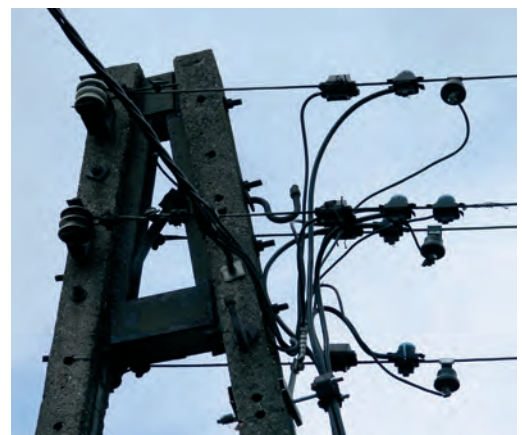
The end of the low voltage overhead line Enden der Niederspannungsfreileitung
