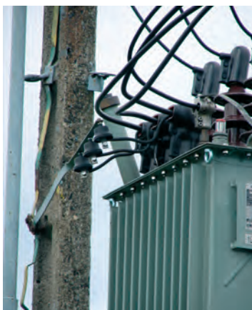
Beginning of the LV overhead line Anfang der Niederspannungsfreileitung
