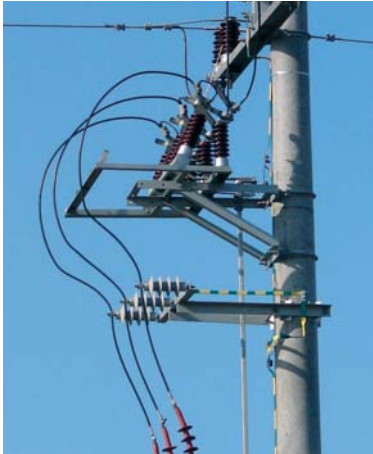
zabezpieczenie kabla SN – zejście z linii napowietrznej
