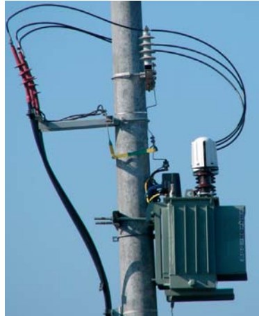
zabezpieczenie uproszczonej stacji transformatorowej 15/0,4 kV
