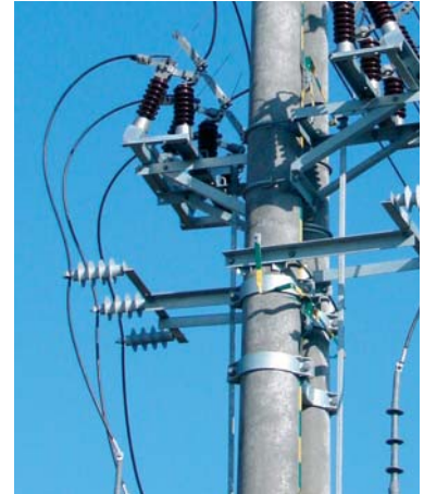
zabezpieczenie kabla SN – zejście z linii napowietrznej
