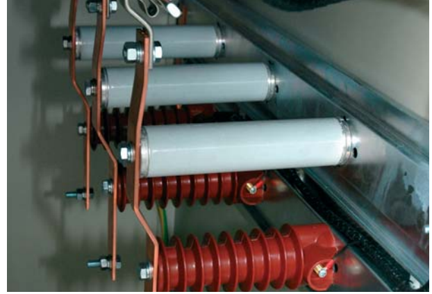
ASW jako zabezpieczenie kabla w polu liniowym stacji
