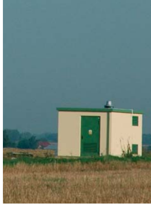
stacja transformatorowa 15/0,4 kV
